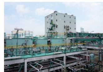
▲バイオ燃料製造実証プラント
