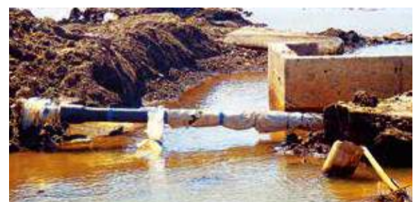
津波にも耐えた耐震管(2011年東日本大震災) 写真提供:仙台市水道局
