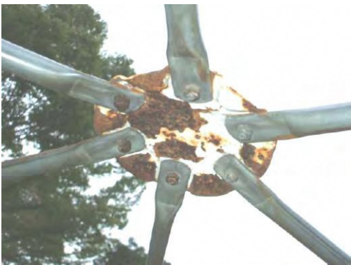
▲ 接続金具の腐食
