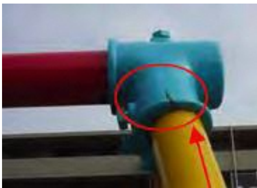
▲ 継ぎ手金具の割れ
