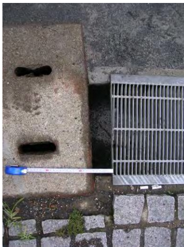
▲ グレーチング 隙間
