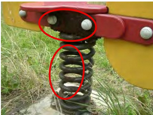
▲ スプリング及び上物取付金具の錆
