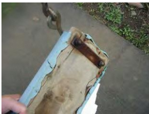
樹脂系素材の劣化状
