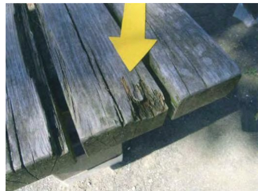
▲ 木製ベンチの腐食
