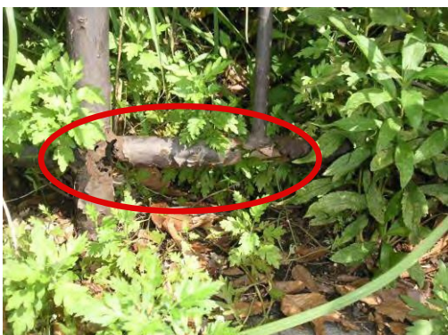
▲ パイプ柵 部材腐食
