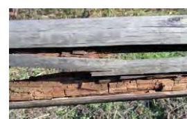
木材の腐朽(褐色腐朽)
