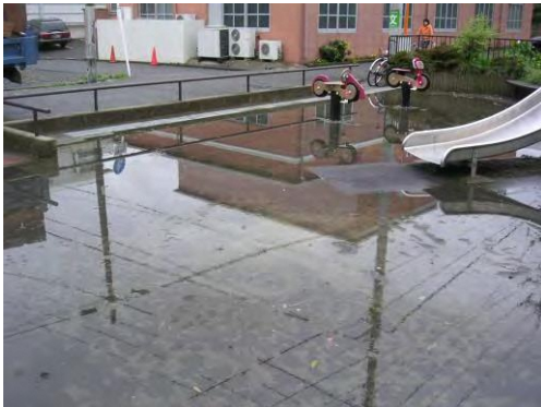
▲ 広場 排水不良
