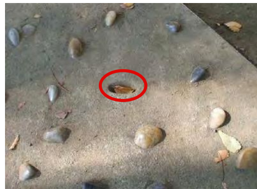
▲ 踏み石の欠落（健康歩道）
