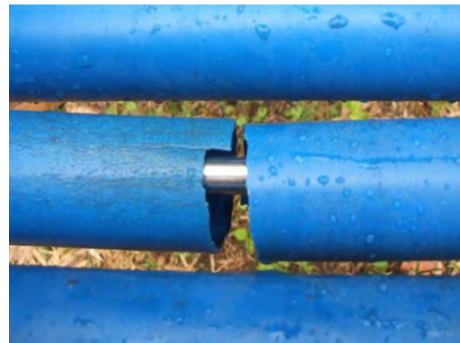
▲ ローラーすべり台のローラー破損
