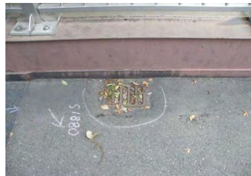
▲ 橋梁の排水施設土砂詰り
