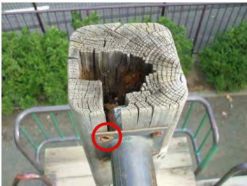
▲ 支柱天端の腐朽及びボルトの欠落
