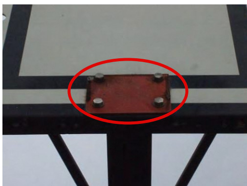
▲ バスケットゴール溶接部の破断
