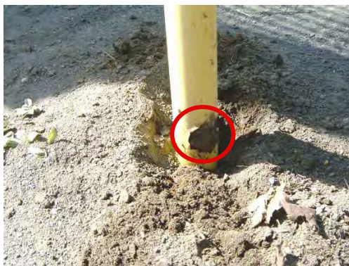
▲ 根際部の腐食（金属柱）
