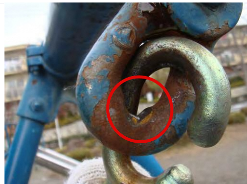
▲ 吊金具の摩耗
