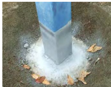
◀ 柱の根際部の 防食テープ 措置事例
