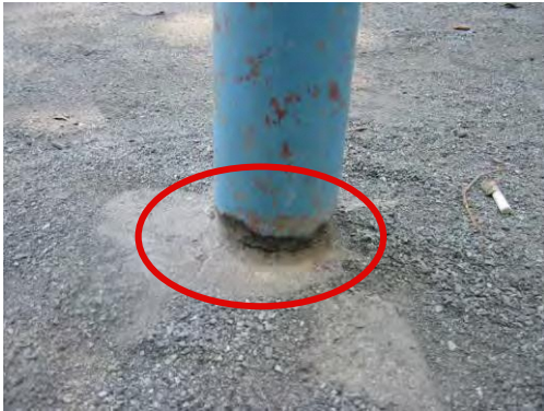
▲ 支柱地際部の腐食及び亀裂
