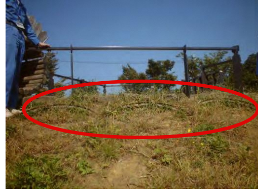
▲ 法枠金物の露出
