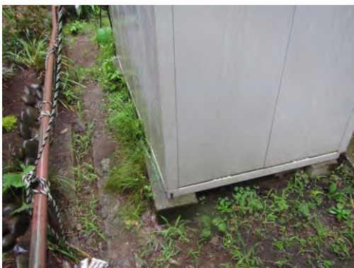
▲ 倉庫 基礎不良
