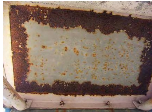
▲ 踊り場（裏側）の腐食
