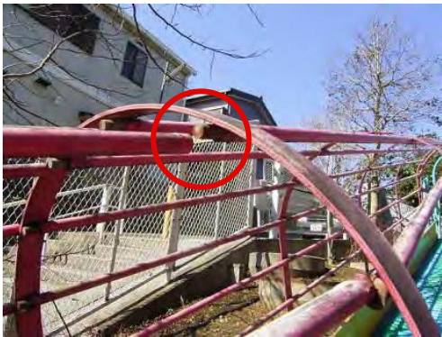
▲ 落下防止柵の接合部の破損
