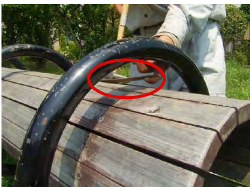
▲ 座板表面の割れ
