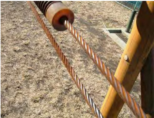
▲ ケーブルの腐食
