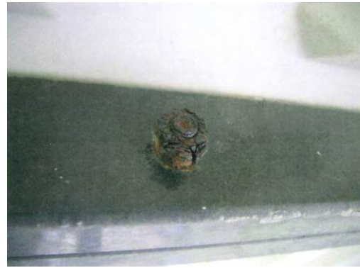
▲ パーゴラ ボルトさび
