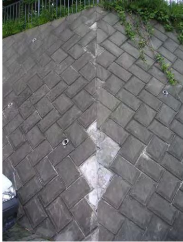
▲ 石積端部の化粧モルタル浮き (浮いたモルタルをはがした状態)
