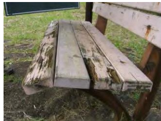
腐朽の中期段階
