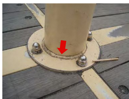
▲ フランジ溶接部の亀裂
