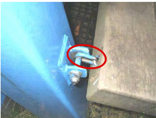
▲ 吊り橋取り付け部チェーンの摩耗
