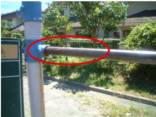
▲ 継ぎ手部分及び握り棒の錆
