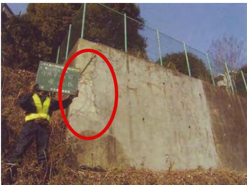
▲ 擁壁表面剥れ
