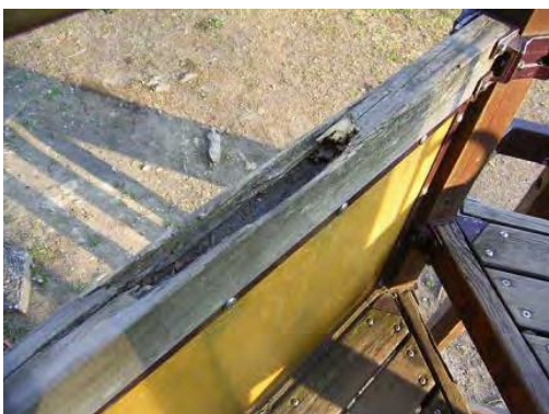
▲ 手すり部材の腐朽
