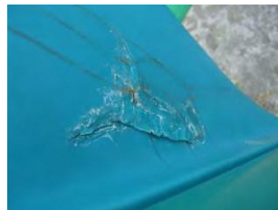
FRPの劣化状況
