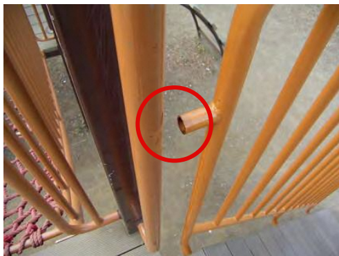
▲ 安全柵取り付け金具の脱落
