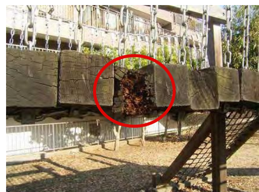
▲ 吊り橋部材の腐朽
