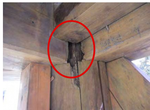
▲ 梁及び支柱の腐朽
