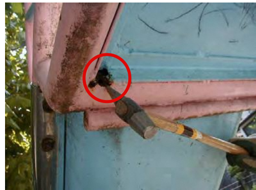
▲ 踊り場の腐食
