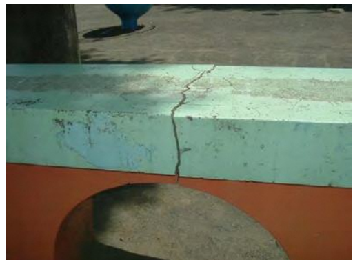
▲ コンクリートの亀裂
