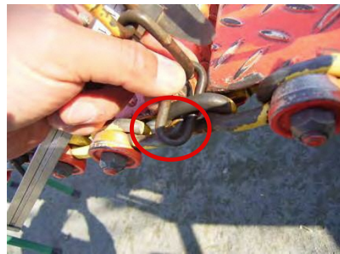
▲ 吊り橋チェーン磨耗
