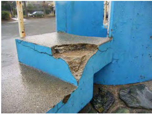
▲ コンクリートの破損
