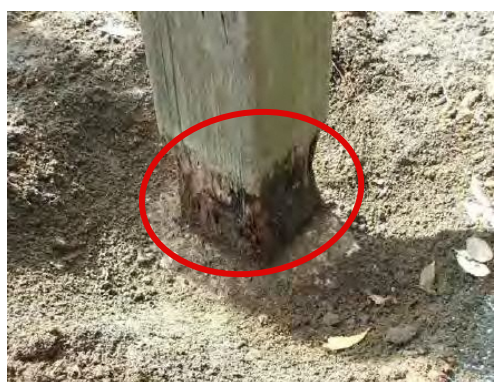
▲ 根際部の腐食（木製柱）
