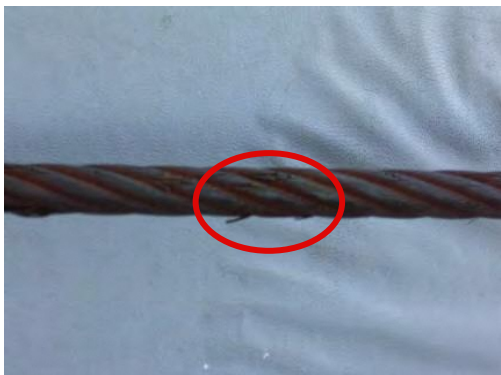
▲ ケーブルの摩耗（素線破断）
