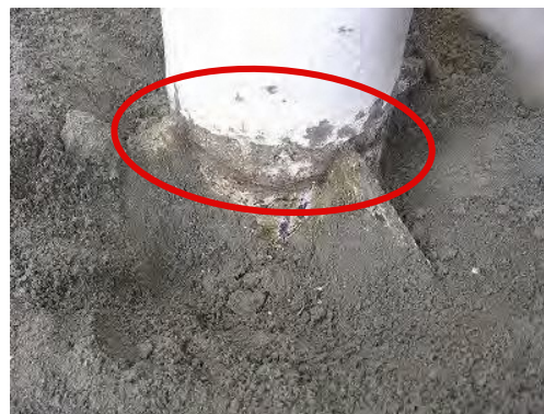
▲ 根際部の腐食及び亀裂
