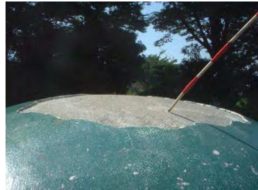
▲ モルタル部の破損
