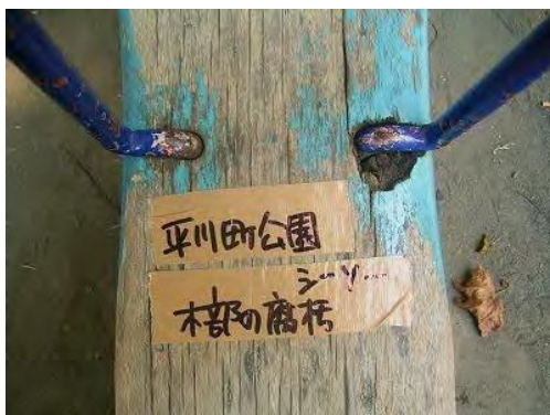
▲ 板の腐朽、取っ手のぐらつき
