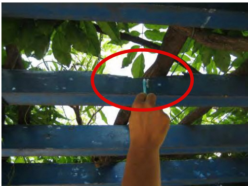
▲ パーゴラ 桟木腐食
