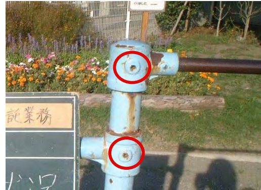
▲ 継ぎ手部分ボルト欠損
