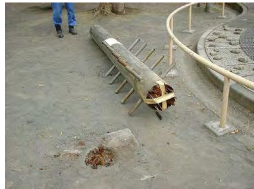
▲ 根際部の腐食による倒壊（木製柱）
