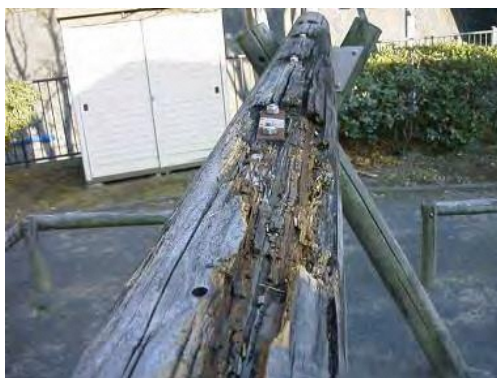
▲ ブランコ梁の腐食（木製）
