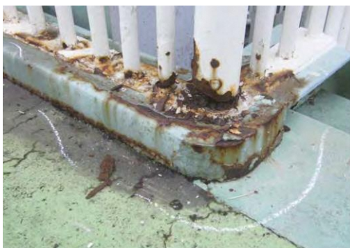
▲ 橋梁高覧（手摺り）の腐食
