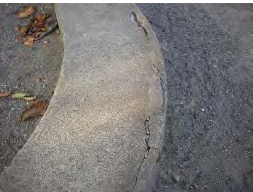
▲ 人研ぎ仕上げの割れ
