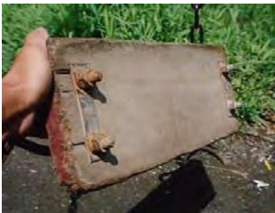
腐朽の初期段階
