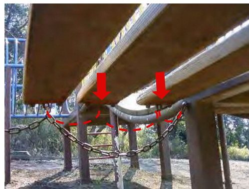
▲ 吊り橋下部ぶれ止めシャックル欠落
