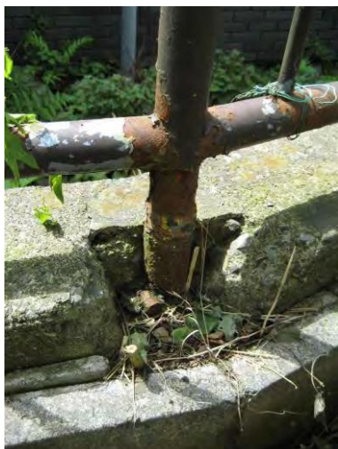
▲ パイプ柵 基礎破損
