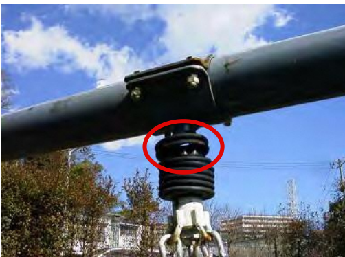
▲ 吊金具カバー破損
