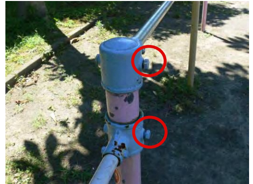
▲ ボルトの飛び出し
