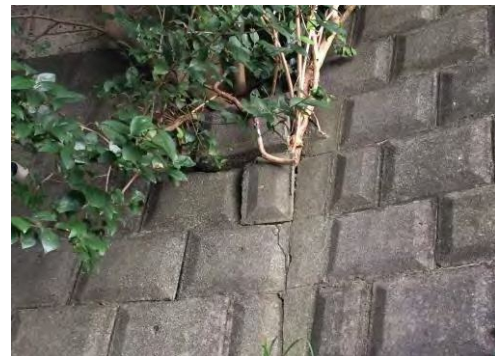
▲ 落下の危険があるブロック
