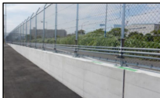
海岸保全施設（止水壁）
